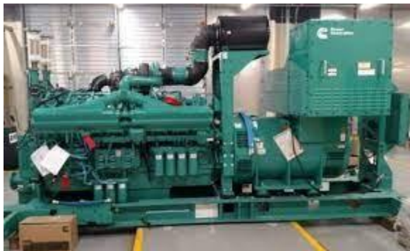
Hệ thống phát điện 300 Kw/giờ
