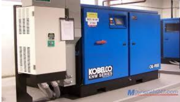
Hệ thống nén Biogas vào bình tích
